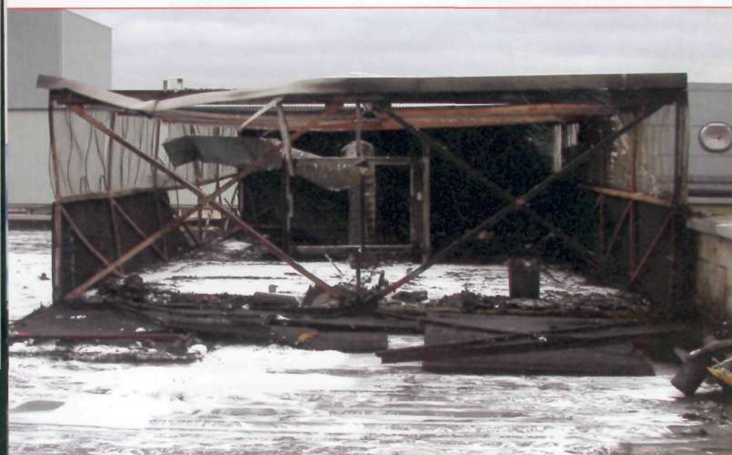
Bild 1: Das Gehäuse der Klimaanlage nach dem Feuer.
