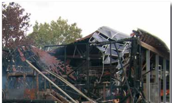
Noch unter Spannung! Photovoltaikanlagenteile nach einem Brand.
